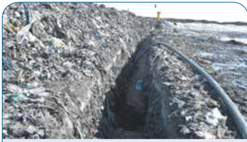
Построена система газосборных трубопроводов, благодаря которым каждая газовая скважина соединяется с газокompрессорной станцией.
