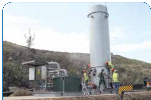
Высокотемпературный факел рассчитан на утилизацию 1000 кубометров газа в час.
